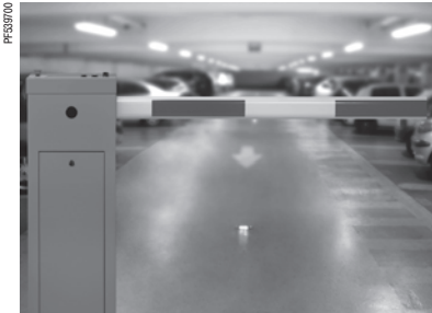
Шлагбаум, управляемый ПЧ ATV 12
