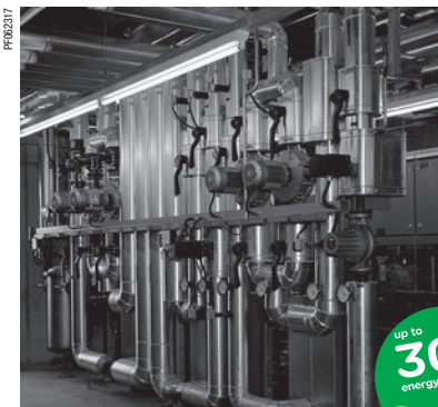
Управление насосной станцией
